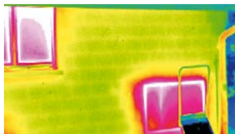
Pont thermique : l'armoire de raccordement électrique
